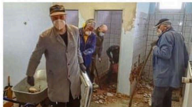
Macher mit Maske: Dirk Brill (von links), Dieter Rehm, Jörg Lingelbach, Ernst Killmer und Karl Trispel bereiten Anfang Mai die Damen-Dusche für die Sanierung vor.
