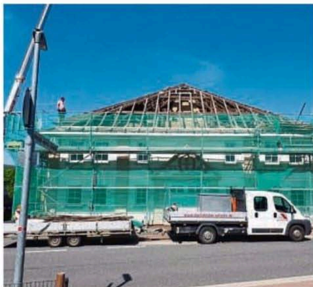
Kostenfaktor: Das rund 1000 Quadratmeter große Ziegeldach der Sporthalle wird komplett erneuert – eine Aufgabe, die der Verein nicht selbst stemmen kann und die einen großen Teil der Kosten der Sanierung ausmacht.
